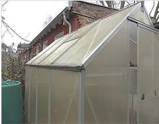
Gewächshaus mit Grünalgenbelag außen
